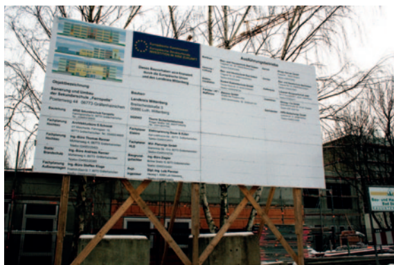
Investitionen in die Schulinfrastruktur erfolgen grundsätzlich nur nach einem erfolgreichen Demografie-Check (Foto: Modernisierung der Sekundarschule in Gräfenhainichen)
